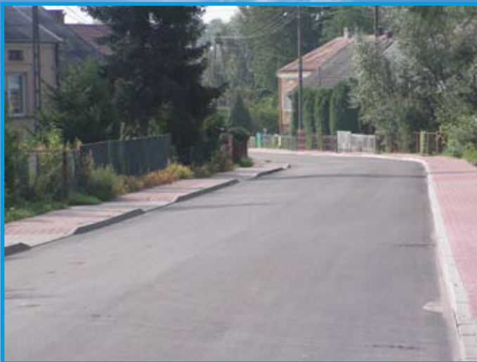
Przebudowa drogi powiatowej Strzelce-Oleśnica, z chodnikiem i kanalizacją burzową na odcinku ul.Żeromskiego realizowana w ramach NPPDL
