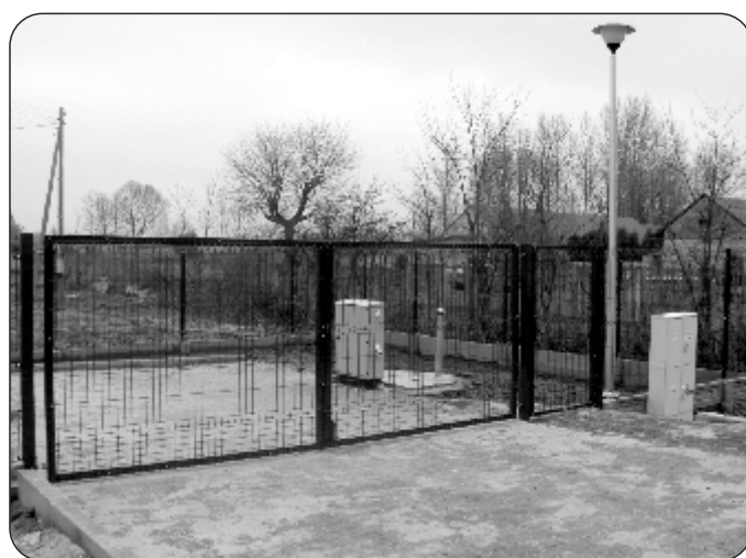
Przepompownia ścieków w miejscowości Wójnowa
